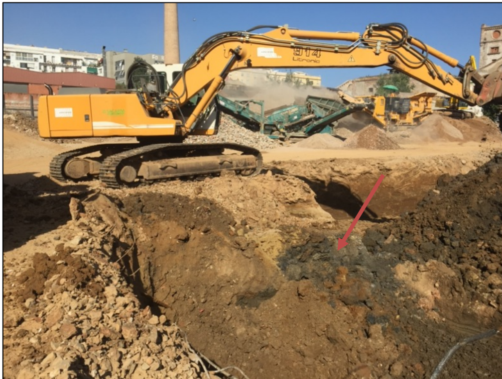
Fotografia 134. Presència de terres contaminades.
