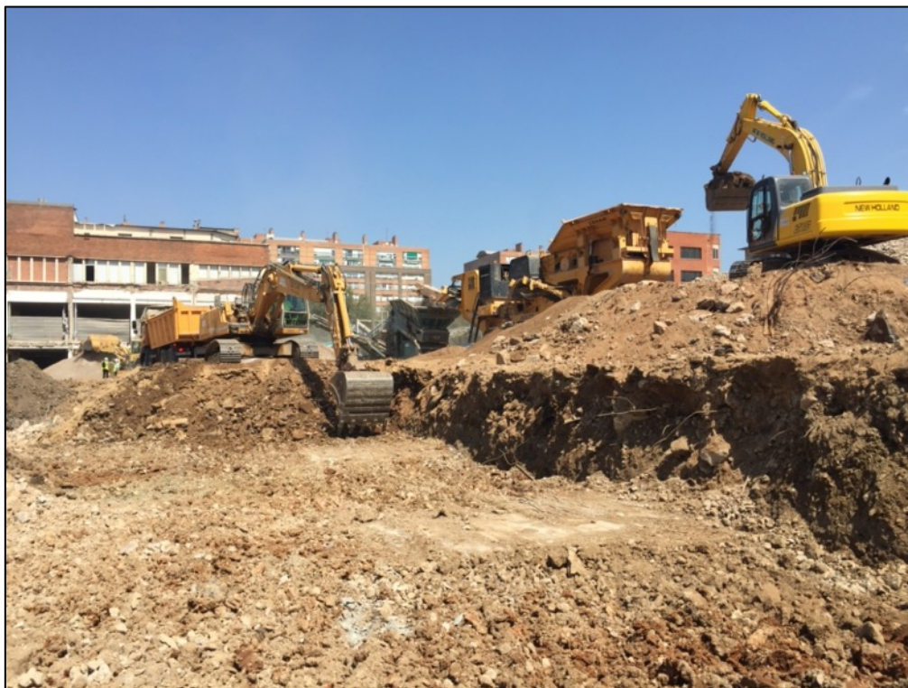
Fotografia 85. Rebaix aportacions de terres contemporànies localitzades en la zona nord del sector B.
