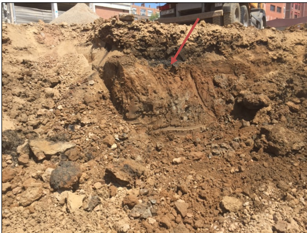
Fotografia 135. Presència de terres contaminades que afecten estratigrafia existent.
