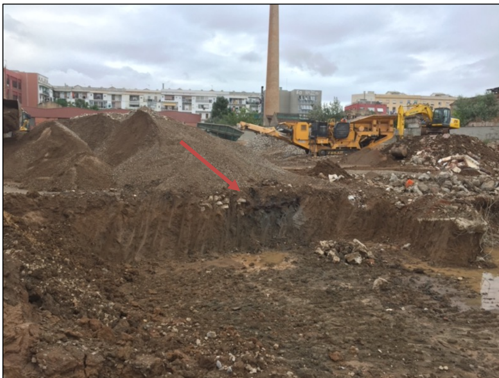
Fotografia 69. Diversos punts amb terres contaminades.
