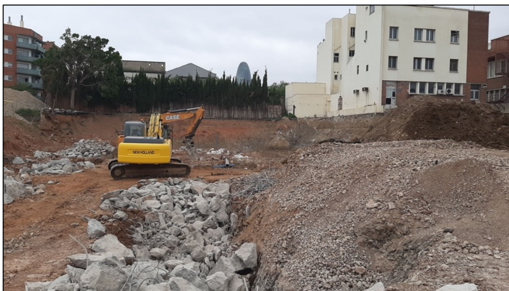
Fotografia 23. Treballs d'extracció de les restes de formigó fruit del desmuntatge de les estructures contemporànies existents en el sector A.
