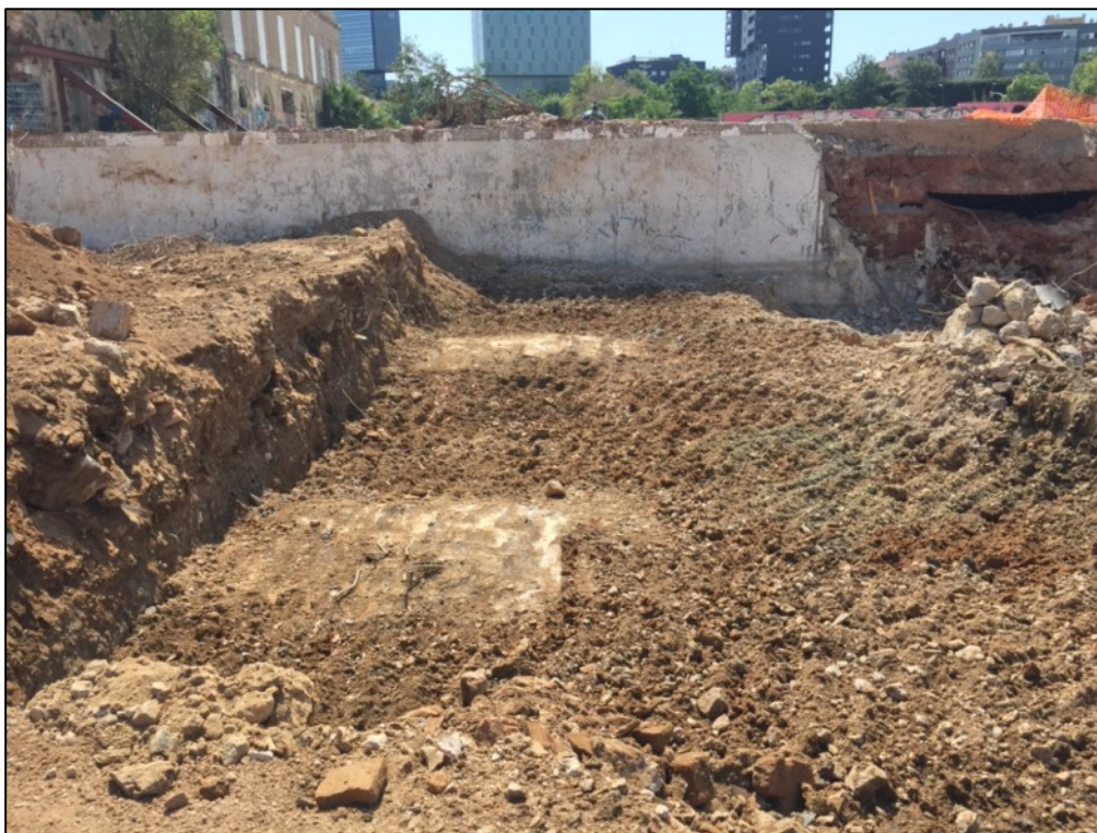
Fotografia 19. Vista general del sector A. Rebaix de l'estrat UE300 en la zona nord del sector A amb aflorament de fonamentacions de formigó.
